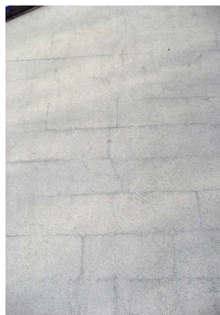
(1) Abzeichnung der einzelnen Dämmplatten in einem WDVS, weil die Verklebung falsch ausgeführt wurde
