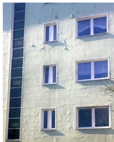
(2) Rissbildung in der Fläche aufgrund zu geringem Kleberanteils am Untergrund und zu geringer mineralischer Armierungsschichtdicke von nur 2 bis 3 mm
