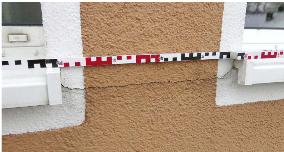
(5) Dieser Riss entstand, weil die Fensterbänke im EPS falsch eingepasst wurden. Es fehlten die Gewebeüberlappung und die diagonale Gewebeamierung.
