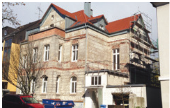
4 Nach dem Entfernen der vorgehängten Fassade wurde das gesamte Ausmaß der zerstörten Stuckfassade sichtbar.
